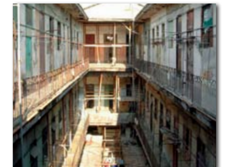
Der Teil des Gebäudes, der noch steht, wird als Wohnhaus genutzt. Der Zustand der Bausubstanz ist jedoch sehr schlecht.
