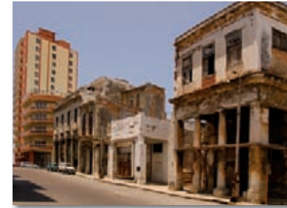
Links oben, an der Ecke, steht das Hotel Deauville, dahinter ist der Malecon. An der Stelle des Hotels befand sich früher die Manufaktur La Corona. Die Häuser daneben könnten noch aus dieser Zeit stammen.
